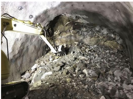
瀬戸トンネル崩落事故 (写真：JR東海)
